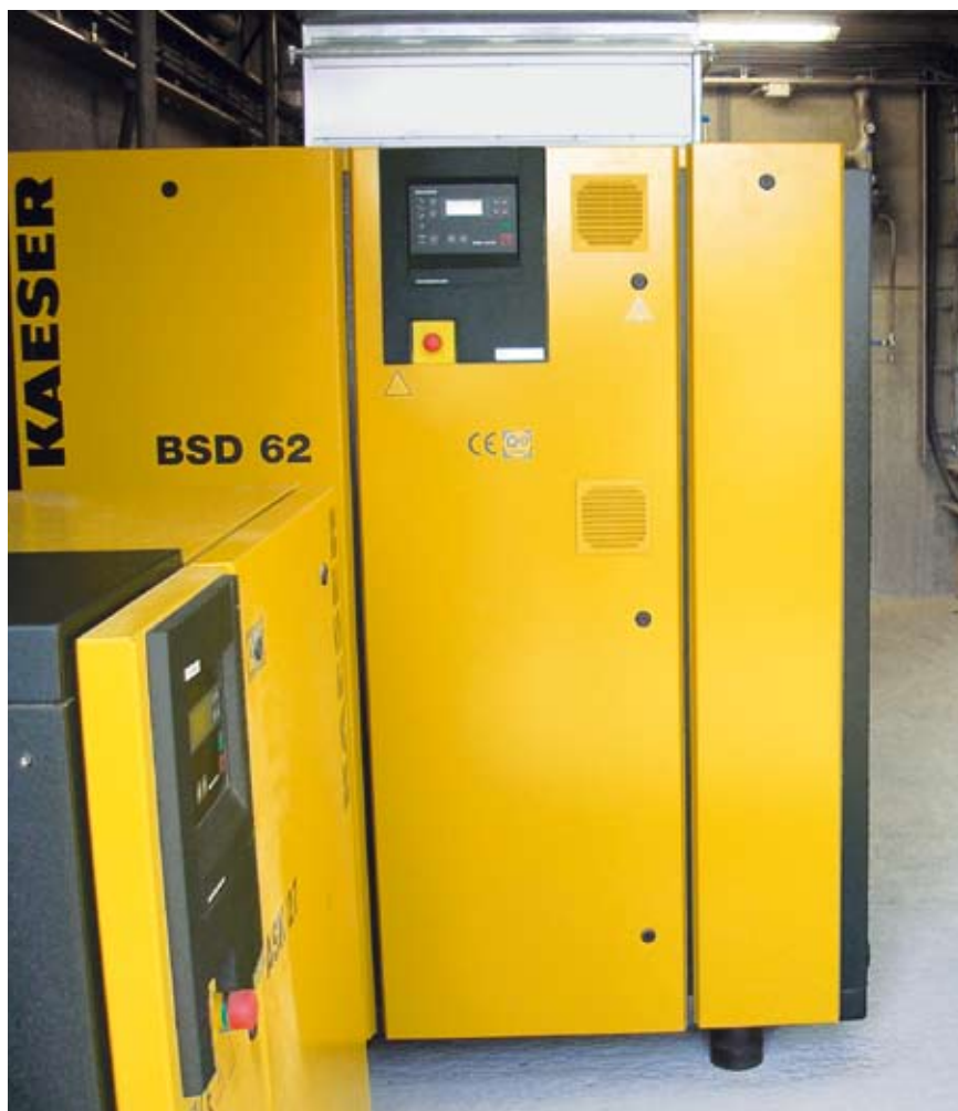
Één van de compressoren in het persluchtstation
